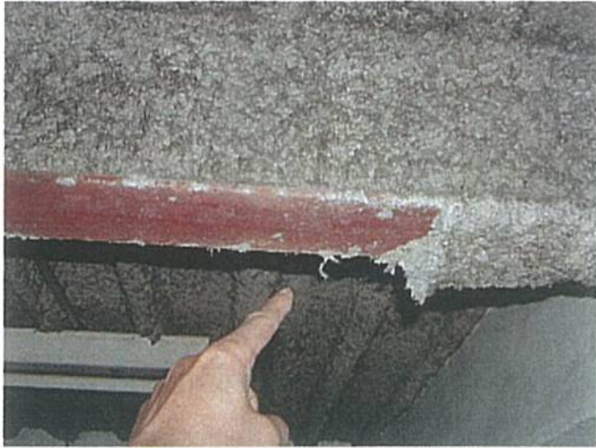
写真の状況：吹き放し工法であり、セメントスラリーもなく脱落箇所がある。
