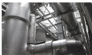
プラント配管
